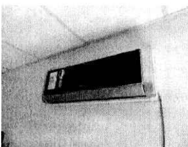
CONDICIONADOR DE AR
