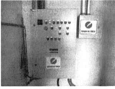
QUADRO DE FORÇA
