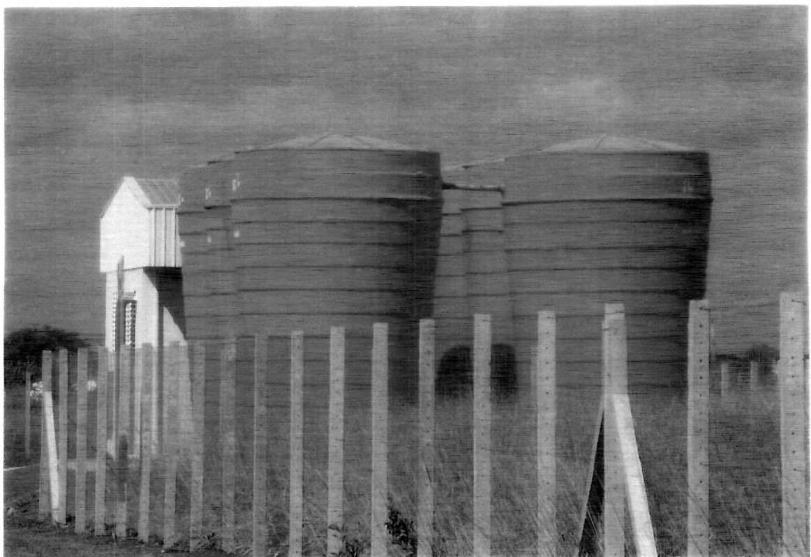
06 CAIXAS D'ÁGUA EXTERNAS.
