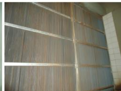
CENTRAL DE CLIMATIZ. - ELIMINADOR DE GOTAS
