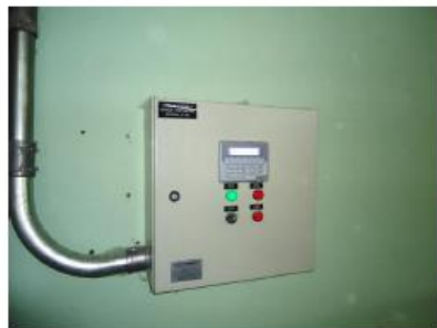
PAINEL DE CONTROLE PARA UMIDADE E TEMP.
