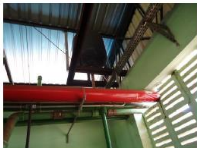
RESERVATÓRIO DE ÁGUA SUPERIOR
