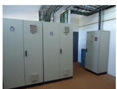
PAINÉIS ELÉTRICOS E PAINEL PARA FATOR POT
