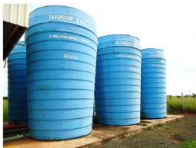
CAIXAS DE ÁGUA - CAPACIDADE 30.000 L (cada)
