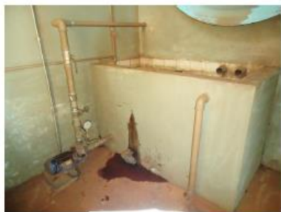
CENTRAL DE CLIMAT. - BOMBA CENTRIF.
