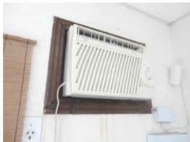
CONDICIONADOR DE AR
