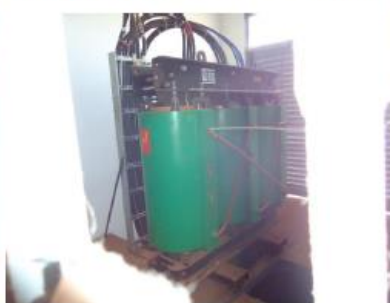
TRANSFORMADOR - POT. 1000KVA
