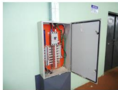
QUADRO DE FORÇA A
