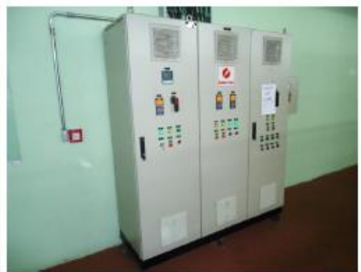
QUADRO DE FORÇA DE COMANDO
