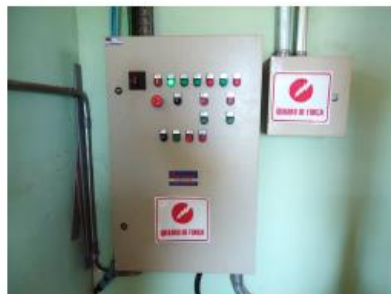
QUADRO DE FORÇA
