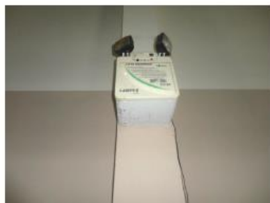
ILUMINAÇÃO DE EMERGÊNCIA
