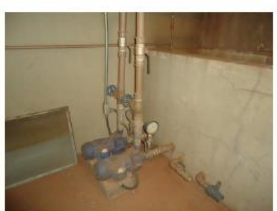
CENTRAL DE CLIMAT. - BOMBAS CENTRIF.
