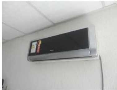
CONDICIONADOR DE AR
