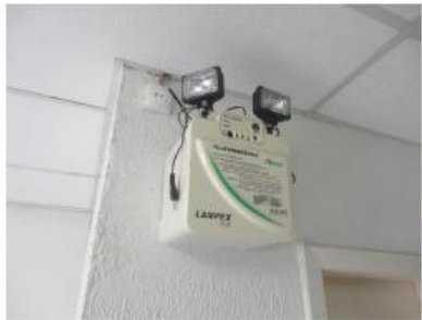
ILUMINAÇÃO DE EMERGÊNCIA
