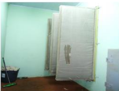
CENTRAL DE CLIMAT. - TELA FILTRAGEM
