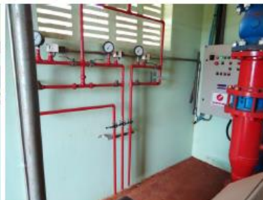
TUBULAÇÕES COM MANÔMETROS
