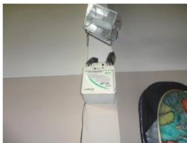
ILUMINAÇÃO DE EMERGÊNCIA
