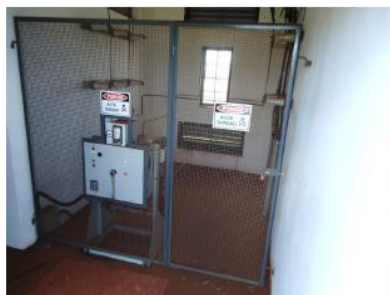
DISJUNTOR - CASA DE ENERGIA
