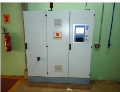
QUADRO DE FORÇA
