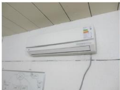
CONDICIONADOR DE AR
