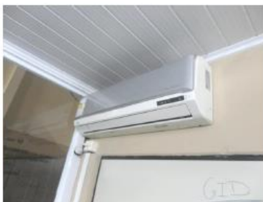
CONDICIONADOR DE AR
