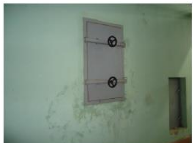
CENTRAL DE CLIMAT. - PORTA DE ACESSO
