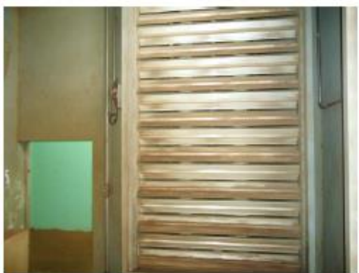
CENTRAL DE CLIMAT. - TELA FILTRAGEM
