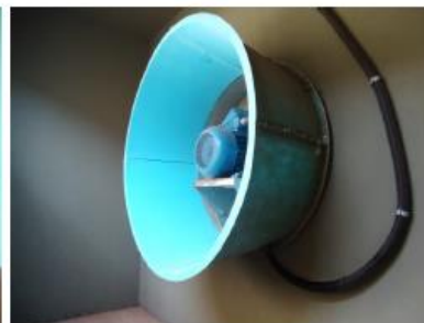
CENTRAL DE RETORNO DE IMPUREZAS - VENTILADOR
