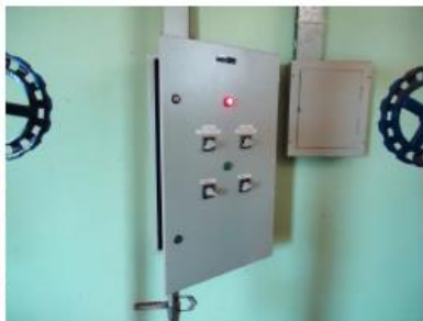
PAINEL DE COMANDO
